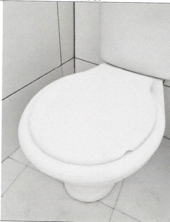
Instalação Hidrossanitária- Centro da Melhor Idade
